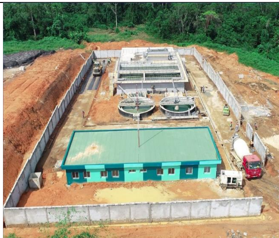
Image présentant le site de la station d'épuration à la zone Industrielle Pk 24 Akoupé-Zeudji
